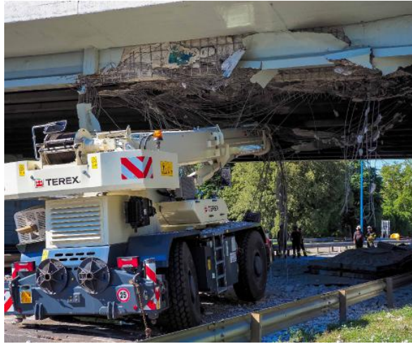
L'autogrù che la mattina del 24 agosto si è incastrata sotto il ponte di via Volturmo lesionandolo gravemente
