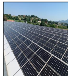
Impianto su capannone
